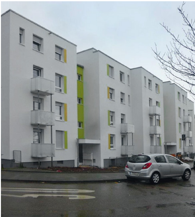
Energetische Modernisierung bleibt ein Kernthema, 2014 unter anderem in der Ingersheimer Straße 3 und 5.
